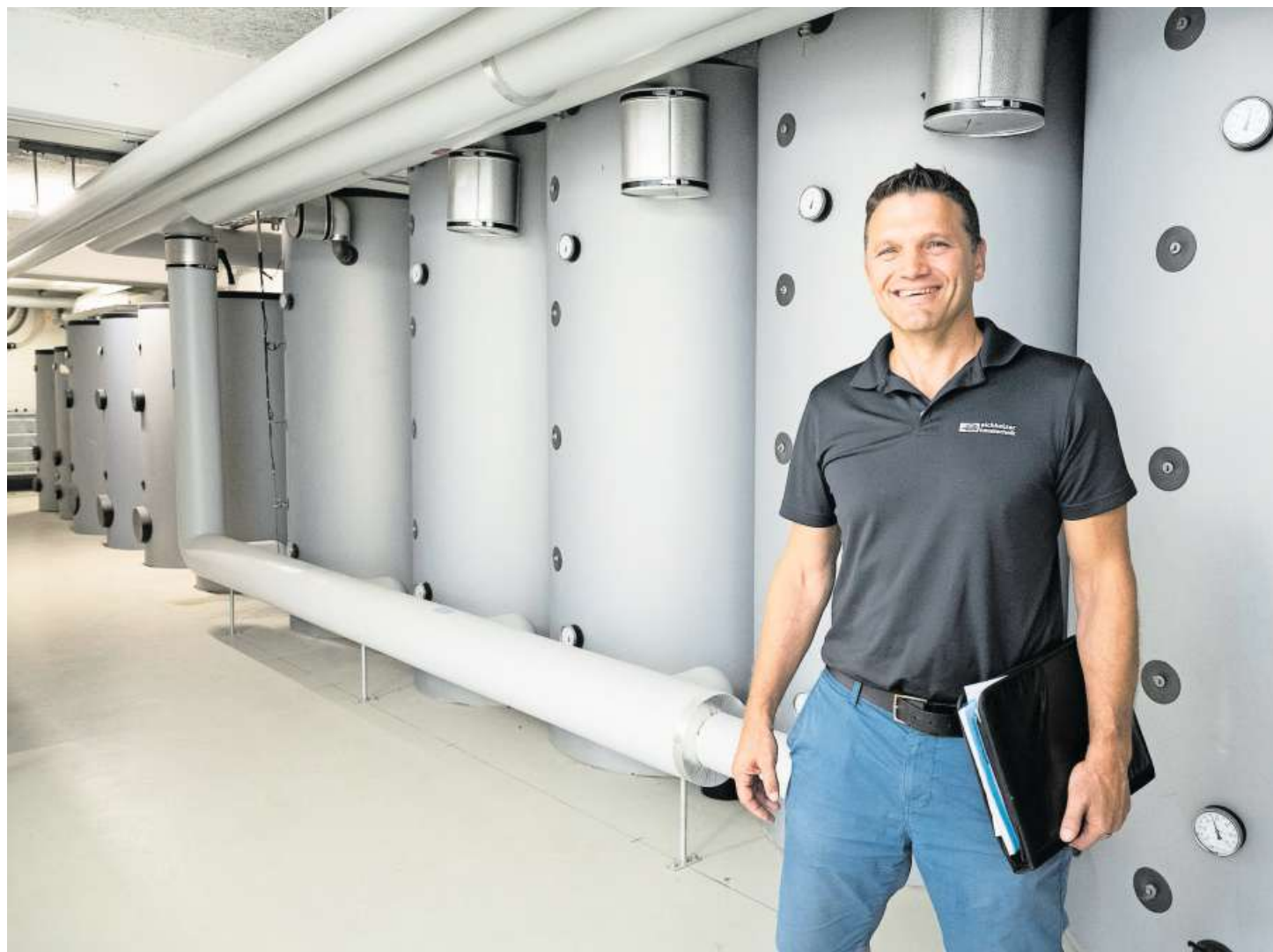
Peter Iten steht vor den technischen Speichern: In diesem Raum standen früher die drei 100 000-Liter-Öl-Tanks.
